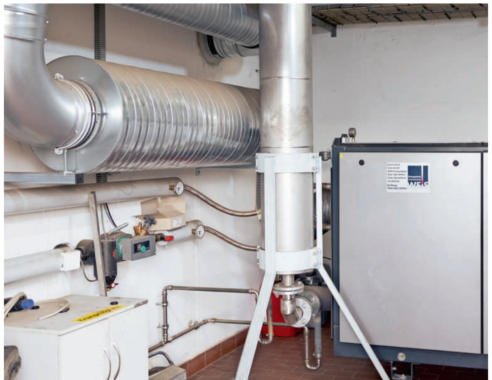
Das Blockheizkraftwerk ist ein energetisch großer Hebel zur Rückgewinnung von Strom aus Wärme. Da es aber mit Gas betrieben wird, sieht Klüh hier Verbesserungspotenziale bei der Elektrifizierung.
